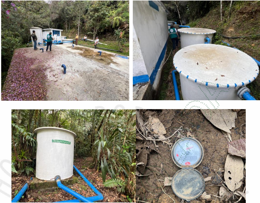
Figura 1. PTAP del Acueducto Multiveredal Cruces. Fuente: Cornare 2025
