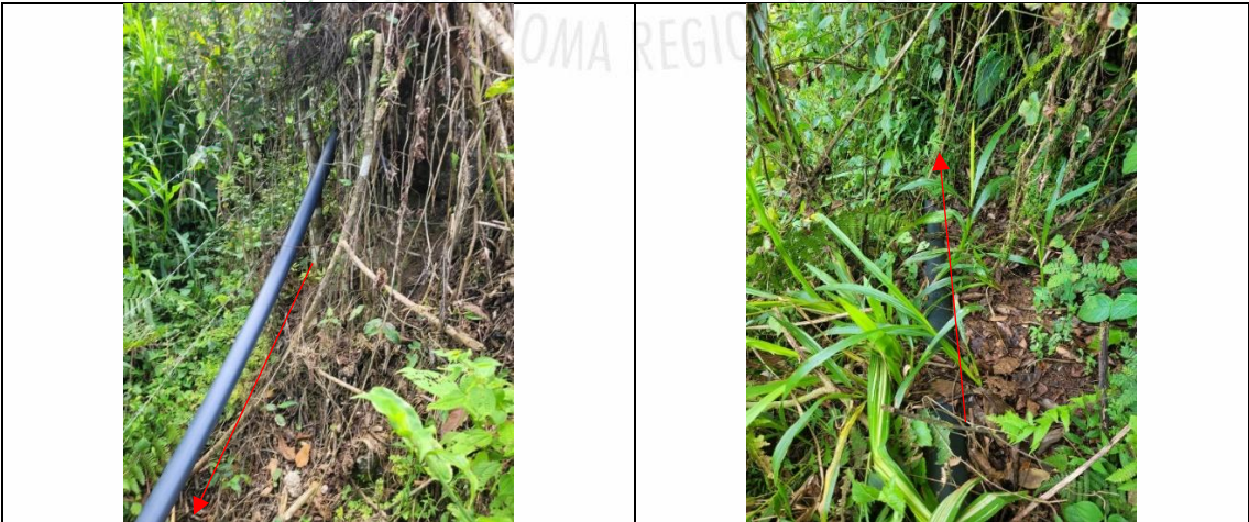
Imagen 5. Tubería que presuntamente transporta las ARD
