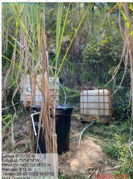
Imagen 2. Punto de captación y tanques de almacenamiento en la fuente La Piedra.
