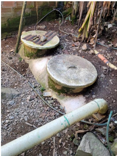
Sistema de tratamiento de aguas residuales domésticas
