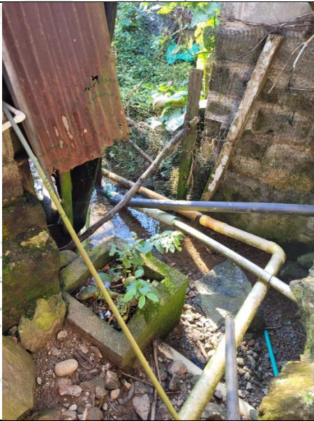
Estado actual, fuente hídrica que atraviesa el predio
