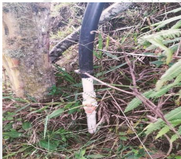
Imagen 8. Tubería con llave de paso.
