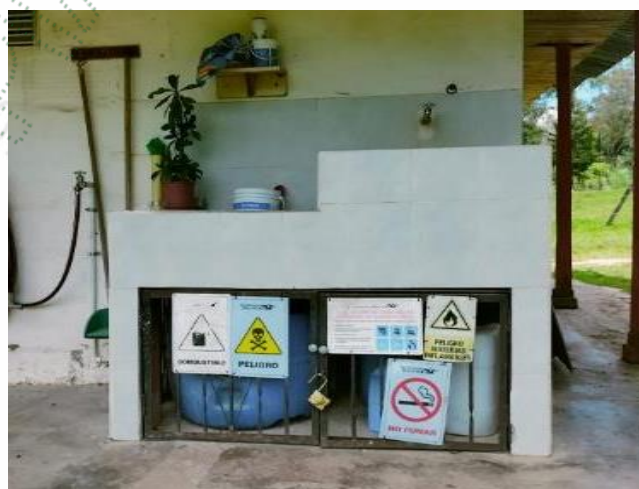
Imagen 9. Tanque de almacenamiento tipo poceta.
