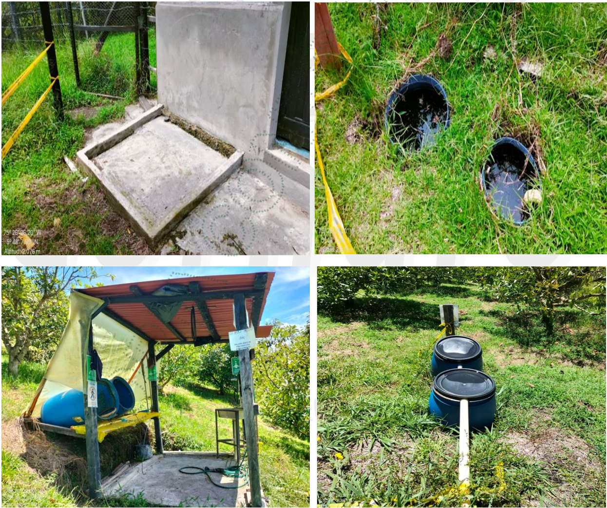
Imagen 12, 13, 14 y 15. Sistema de tratamiento de aguas residuales no domésticas instalado en el predio.
