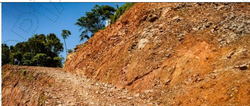
Fotografía 2. Corte de talud y estado de la vía en la parte superior. Fuente: CORNARE
