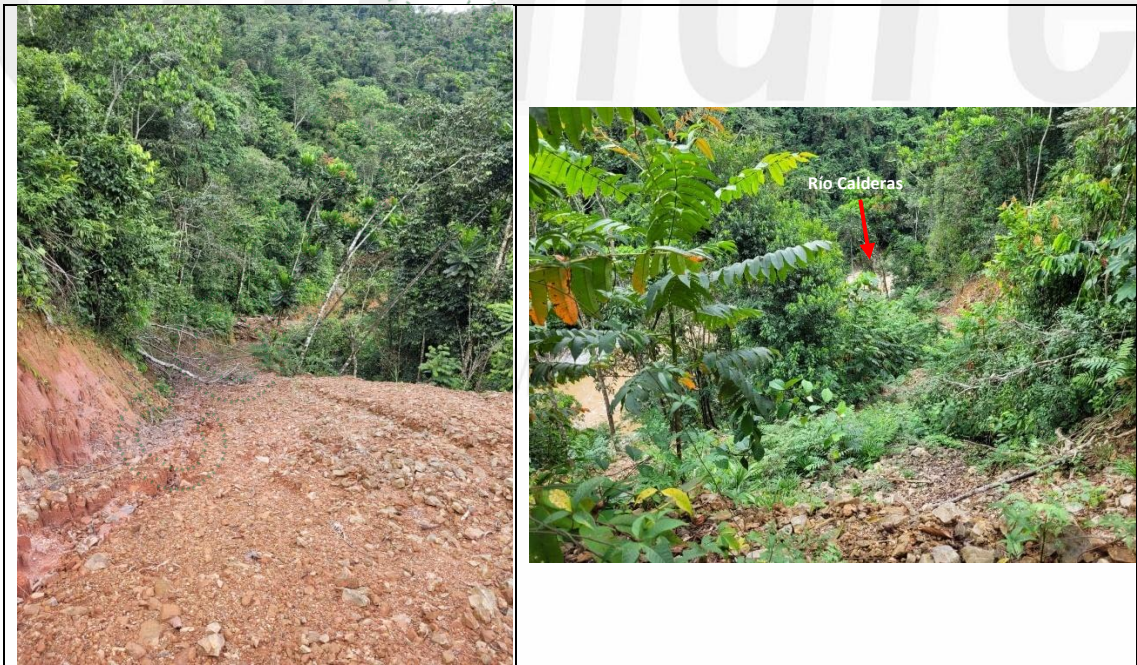
Imagen 20. Estado punto final de la nueva apertura de vía sobre un sitio con coordenadas, evidenciado en la visita técnica de control y seguimiento (25 de febrero de 2025)
