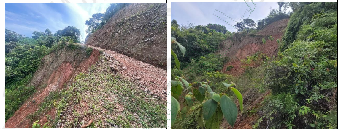
Imagen 4. Estado Parte superior del deslizamiento – Corte vertical en vía evidenciado en la visita técnica de control y seguimiento (25 de febrero de 2025)
