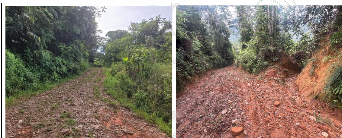
Imagen 2. Estado apertura de vía evidenciado en la visita técnica de control y seguimiento (25 de febrero de 2025)
