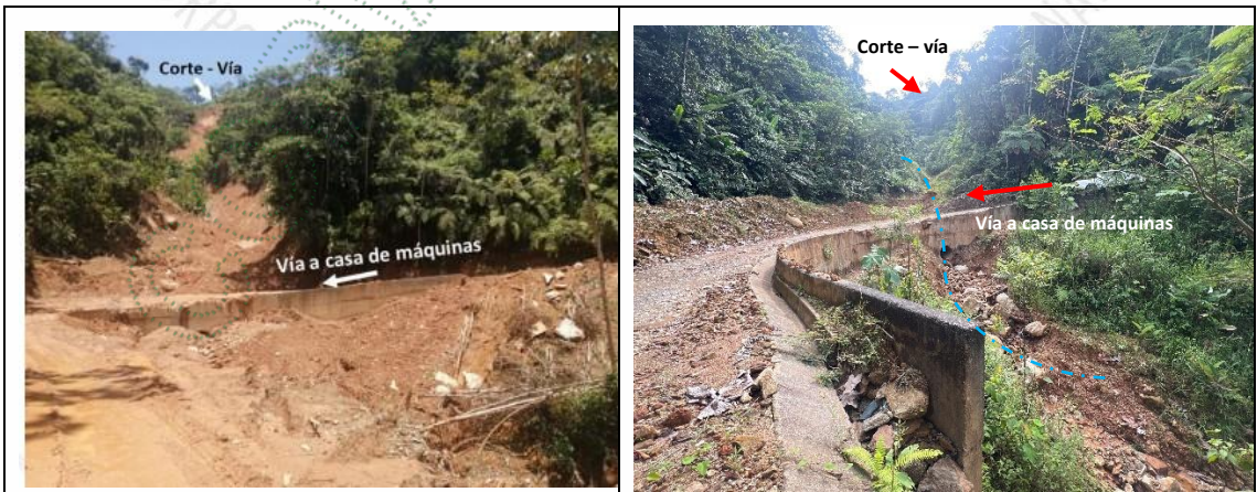
Imagen 5. Estado Parte baja del deslizamiento – vía a casa de máquinas evidenciado en la visita técnica de atención a queja ambiental (30 de agosto de 2022)
