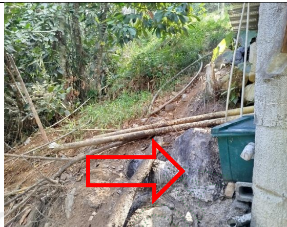
Figura 8. Descarga de trampa de grasa del restaurante a campo abierto.
