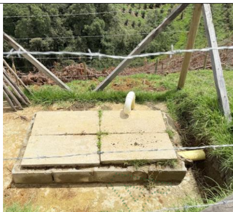
STARD vivienda principal. Presenta buenas condiciones, pero no cuenta con caja de registro a la salida del sistema.
