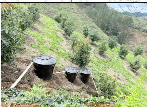
STARnD principal, instalado y en funcionamiento. Aun no se implementa la recirculación.
