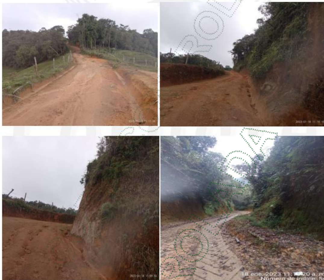
Estado actual de la vía La aldea – San Pedrito.
