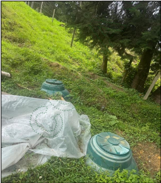
Imagen 1. Aranzalez, S.J. (2025). Sistema de Tratamiento de Aguas Residuales - STAR, Rionegro.
