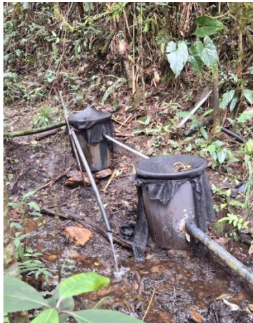
Imagen 2. Captación y Control
