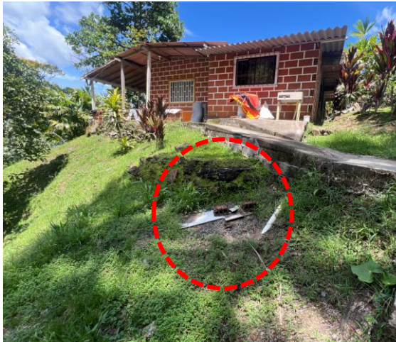
Foto 7. Tanque séptico de la vivienda familiar y una cabaña.
