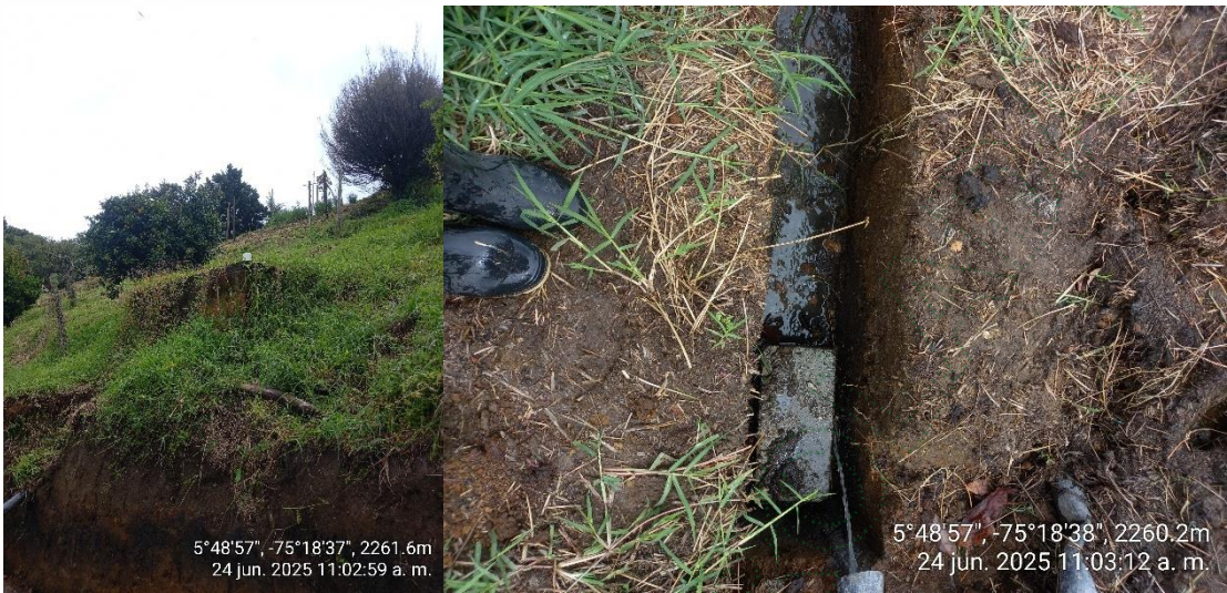
Imagen 5. Pozo séptico y aguas negras vertidas en el predio con FMI: 002-7692
