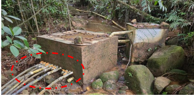
Figura 5. Desarenador y tanque de almacenamiento
