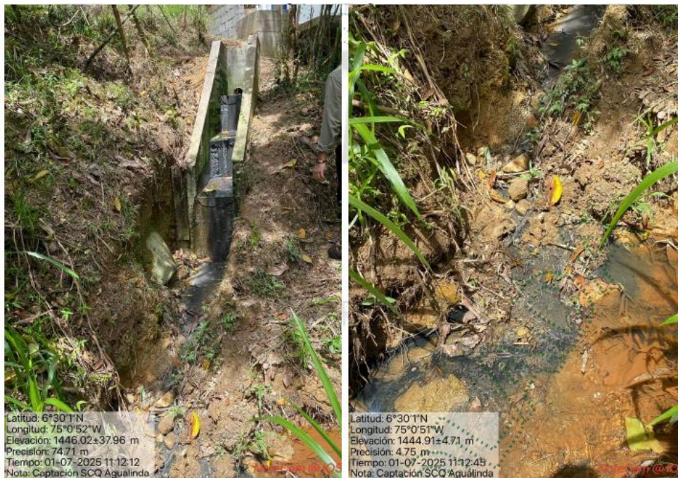
Imágenes 3 y 4. Descarga del efluente de la PTAR sobre la fuente hídrica.
