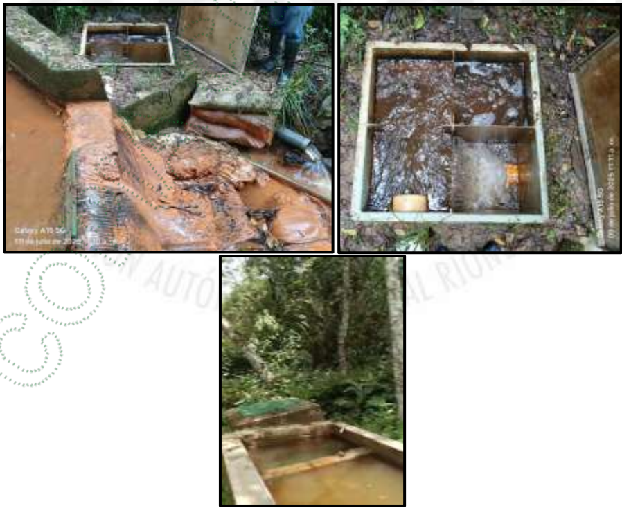
Imágenes 1, 2 y 3: Toma de rejilla, caja de derivación y desarenador
