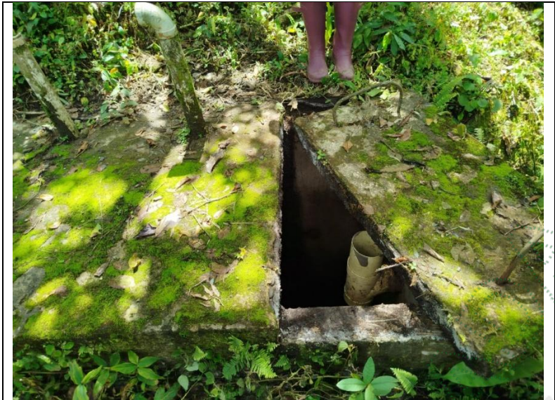
Figura 5. Tanque séptico del CER San Isidro.
