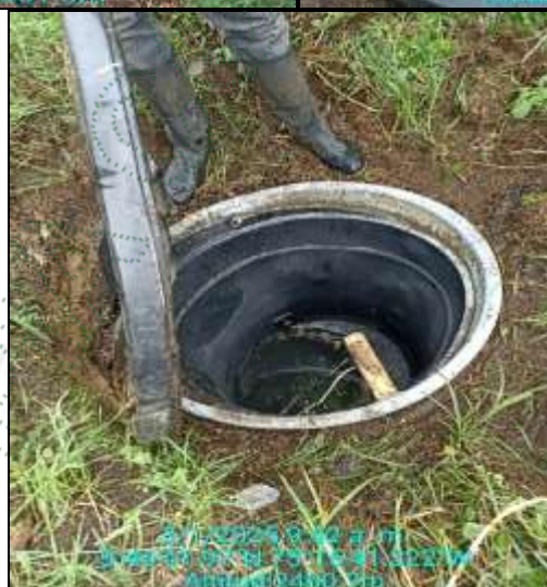
Pozo de desactivación ARnD
