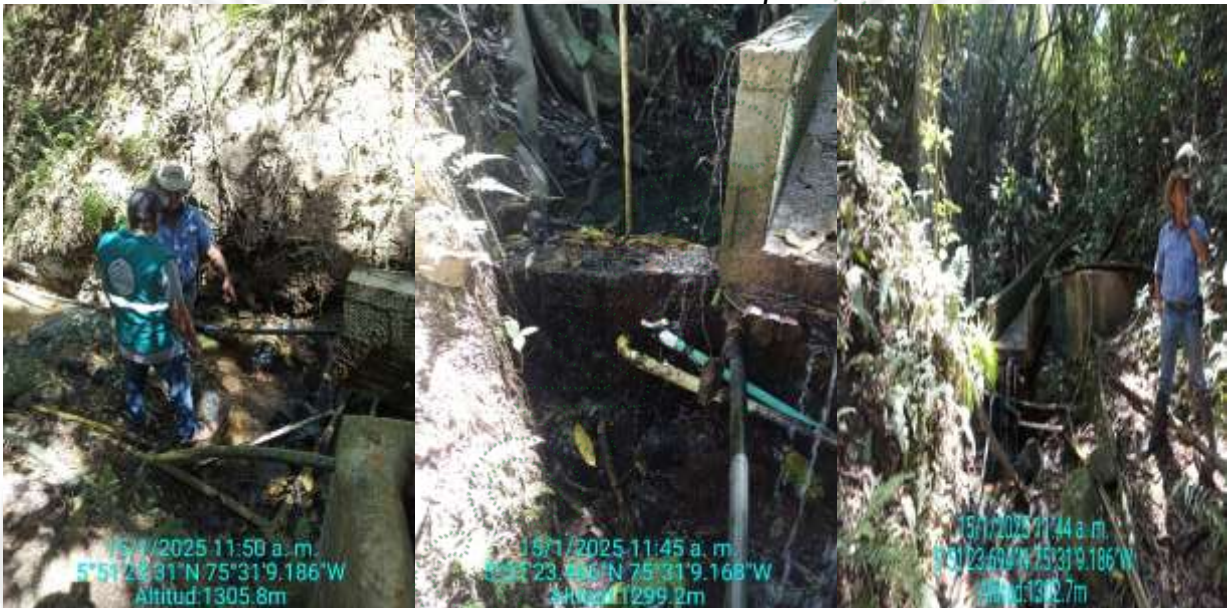
Captación El Trapiche
