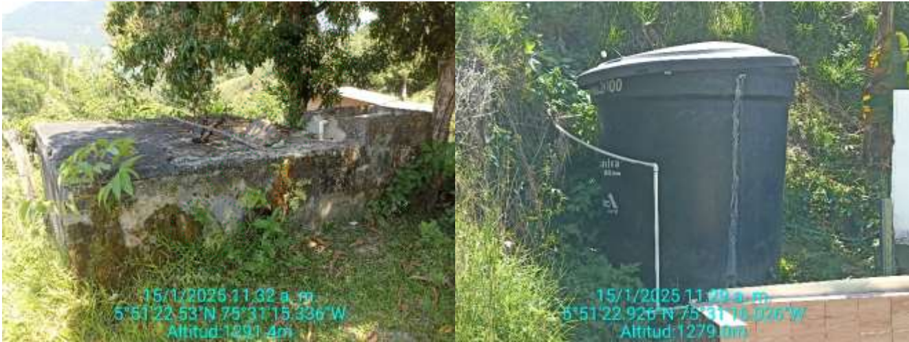
Tanques de almacenamiento
