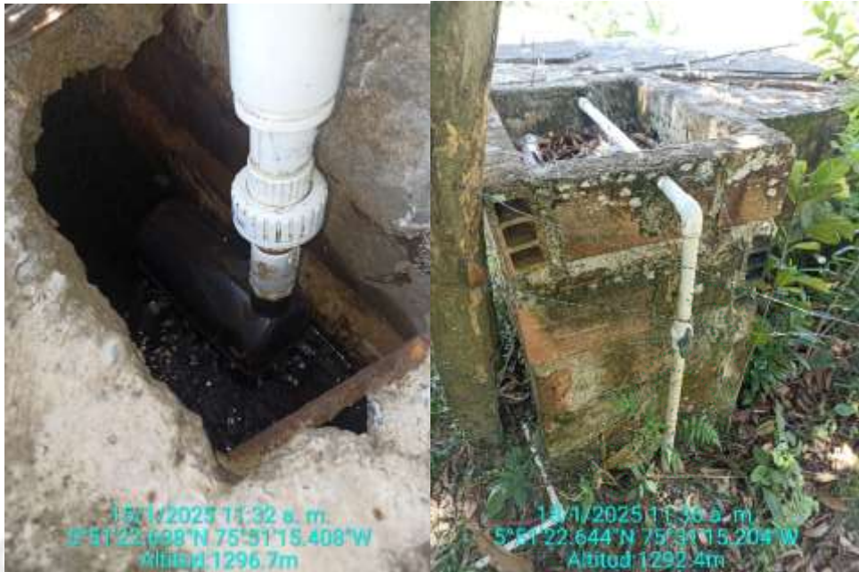
Flotador y tubería para control de flujo
