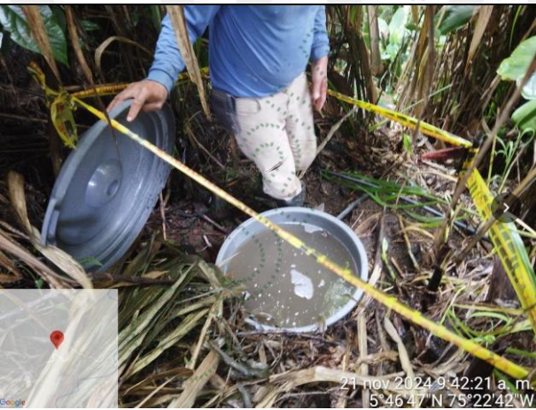
Pozo de desactivación con descarga a drenaje sencillo suelo
