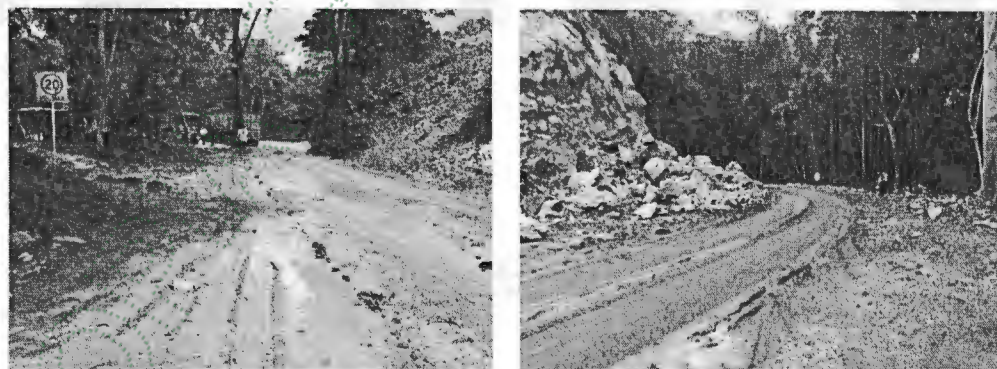
Fotografía 3. Deterioro de la vía por falta de manejo de agua de escorrentía
