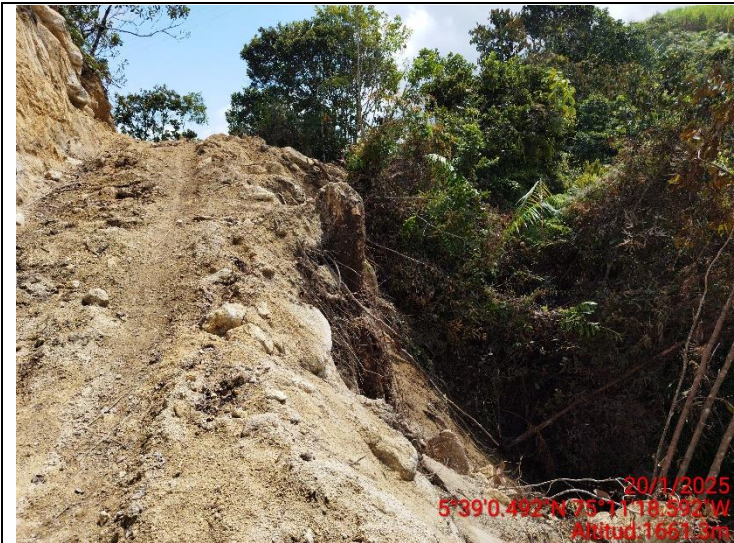
Talud y arbustos afectados
