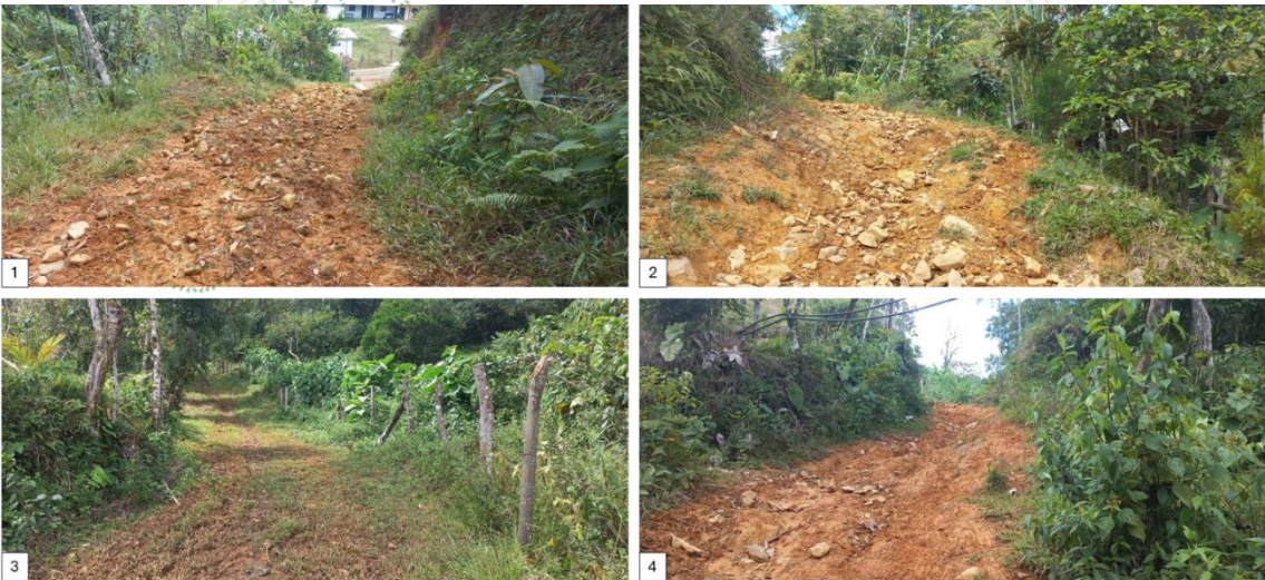
Figura 1, 2, 3 y 4: Vía aperturada con signos de erosión. Fuente: Cornare, 2024
