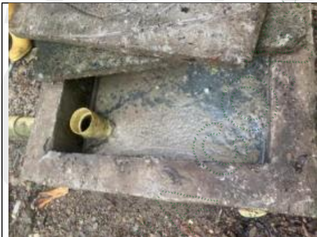
Figura 1. Estado actual Pretratamiento Trampa de grasas
