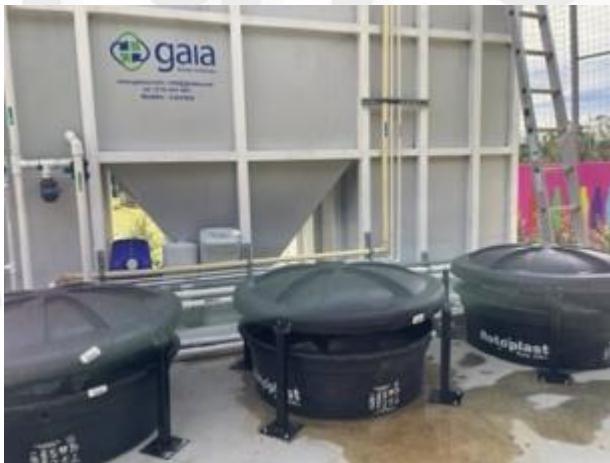
Sedimentador y tratamiento de lodos.
