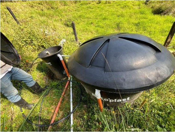
Imagen 3. Medido de caudal implementado
