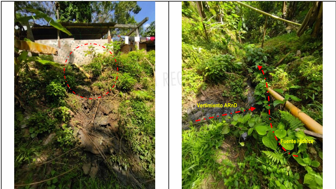
Imagen 5. Tubería de descarga de las aguas residuales no domésticas sin tratamiento previo
