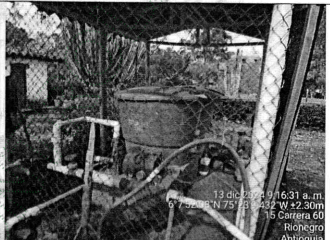
Foto 5. Tanques de almacenamiento y distribución.
