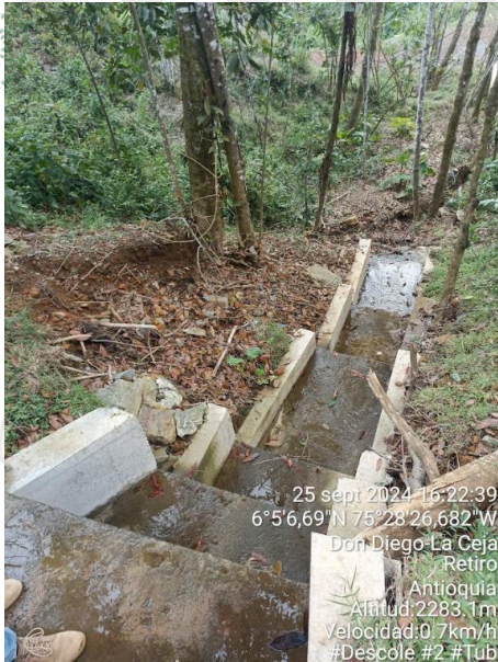
Imagen N° 8. Escalones de disipación en descole Tubería 2, contruidos sin autorización
