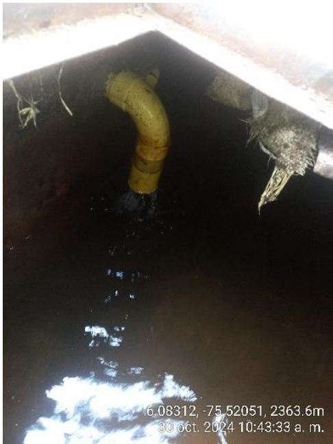
Imagen 3. Tanque de control de caudal
