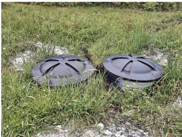
Imagen 4. Tanques de bombeo almacenamiento
