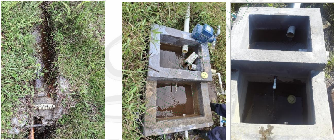
Imagen 1. Captación Artesanal Imagen 2 y 3 Estructura en concreto para Control de caudal.
