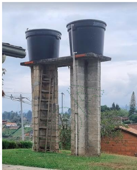
Imagen 5. Tanques de almacenamiento
