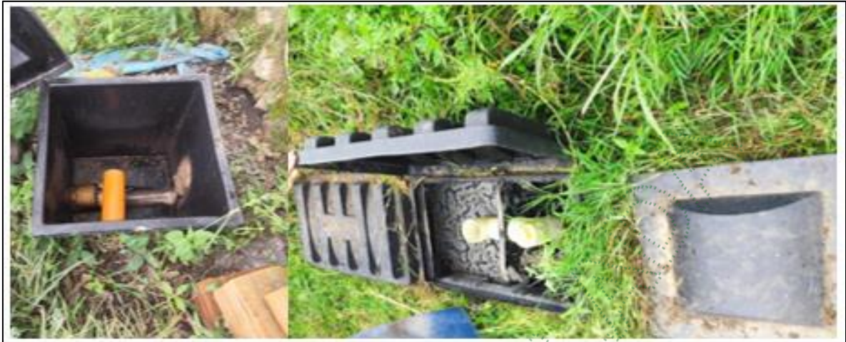
Estado unidades sistema de tratamiento (Trampa de grasas, sistema de tratamiento de aguas residuales)
