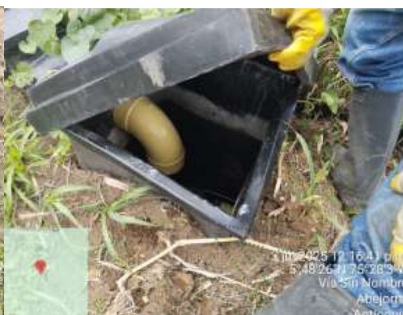
Caja de inspección
