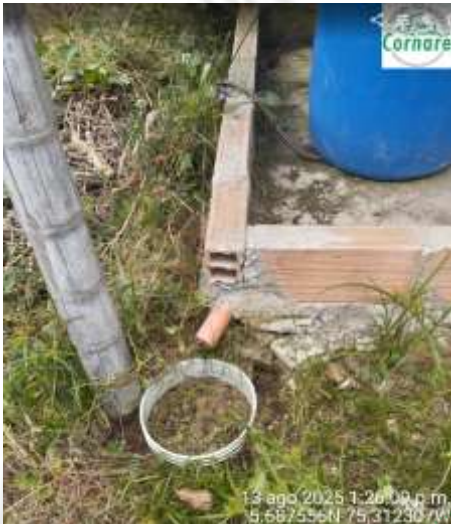
Pozo de desactivación con descarga al suelo
