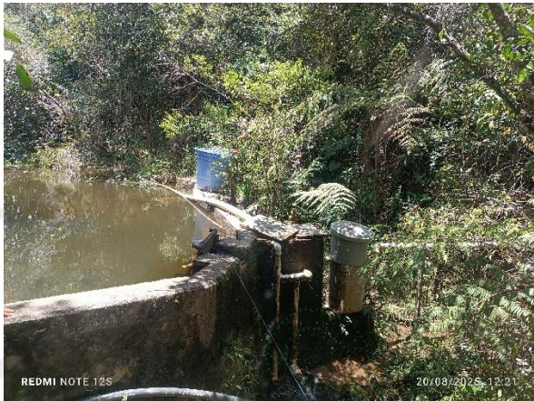
Figura 4. Captación en la fuente denominada “QUEBRADA ALTO DE LA VIRGEN”
