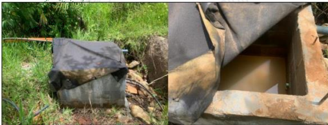
Figura 12: Tanque de distribución, desconectado
