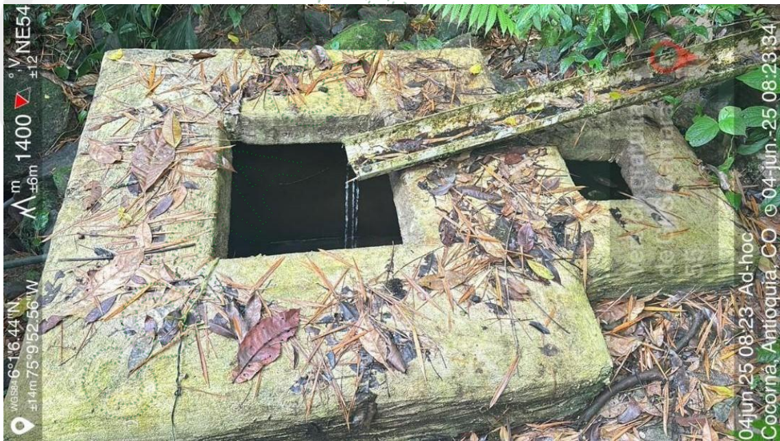
Imagen 1: Tanque de almacenamiento y distribución
