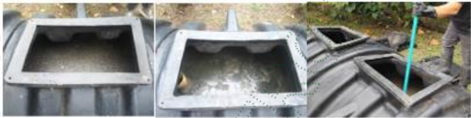
Foto No 2. Sedimentadores tanques sépticos
