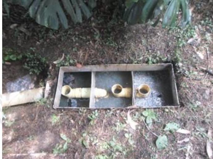
Foto No 6. Sistema de tratamiento Portería
