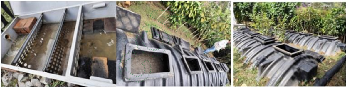
Foto No 3. Secuencia de conexión unidades de tratamiento.
