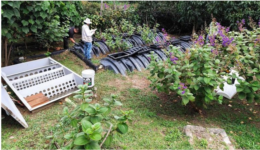
Foto No 1. Conformación general del sistema de tratamiento
