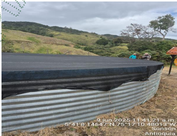
Imagen 4. Tanque de almacenamiento.
