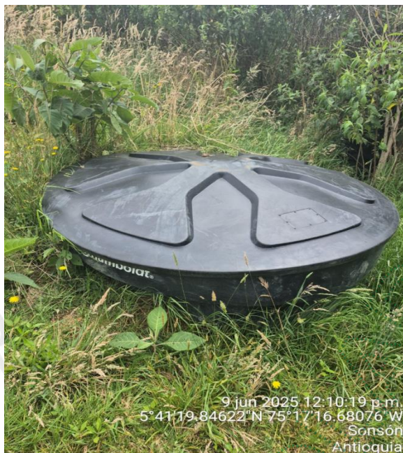
Imagen 9. Tanque de almacenamiento ARnD.
