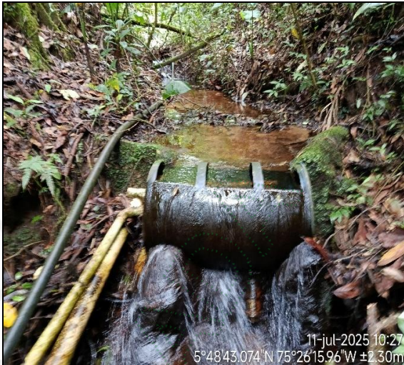
Captación La Toma 2, fuente hidrica La Toma
