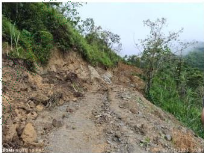
Fotografía 5. Talud sin manejo técnico adecuado.
