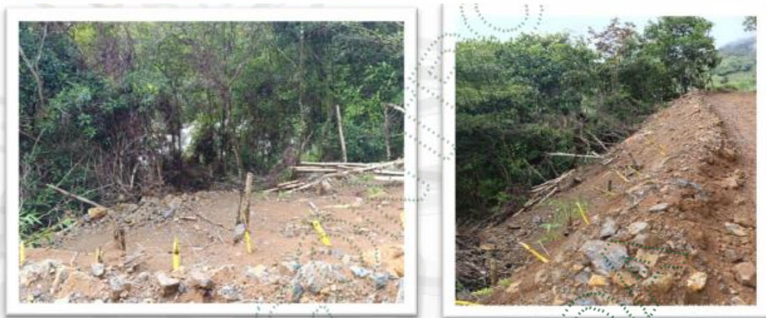
Fotografía 2. Corte de talud sin estabilización.
