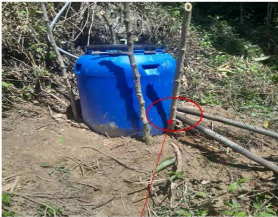
Tanque temporal y acometidas con manguera de 1' pulgada para las viviendas de los señores Manuel y Oscar Henao.
