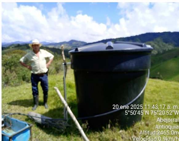
Sistema de almacenamiento
