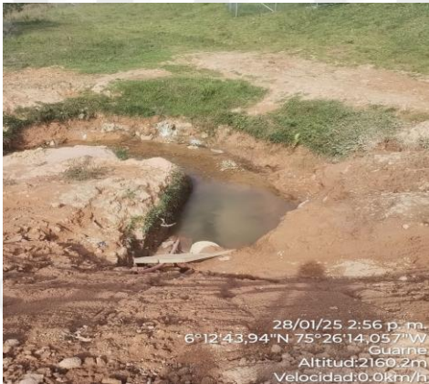
Ilustración 11 Descole tubería provisional
