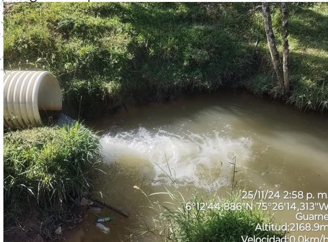
Ilustración 6 Punto descole tubería no autorizado.
