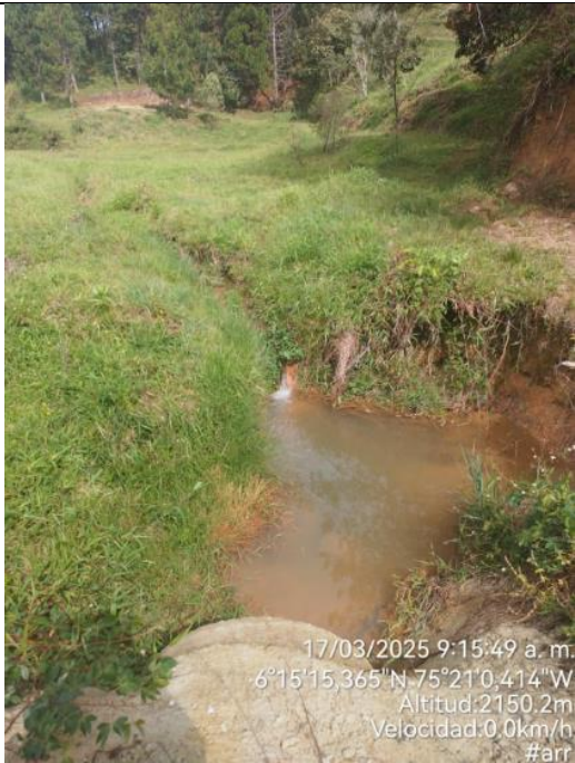
Ilustración N° 3. Tubería en concreto implementada - Aguas arriba
