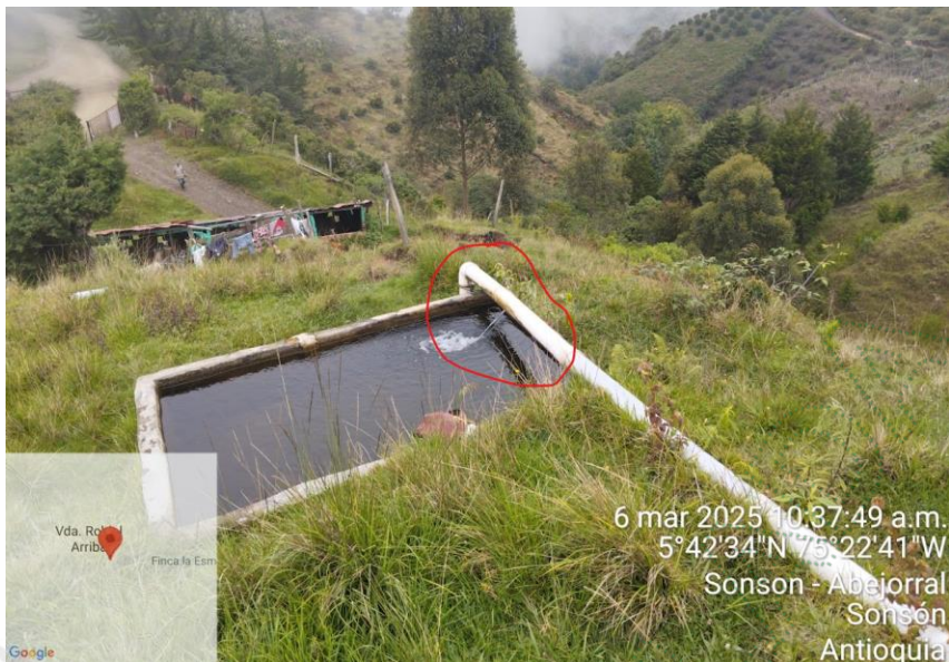
Tanque de almacenamiento con derivación a usuario sin control de caudal
