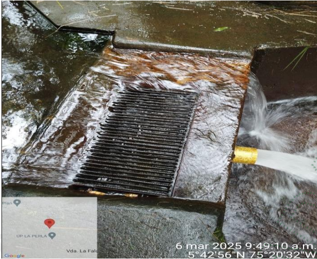
Rejilla de captación
