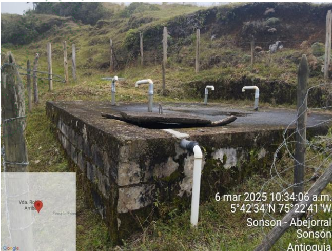
Tanque de almacenamiento de 125000 litros
