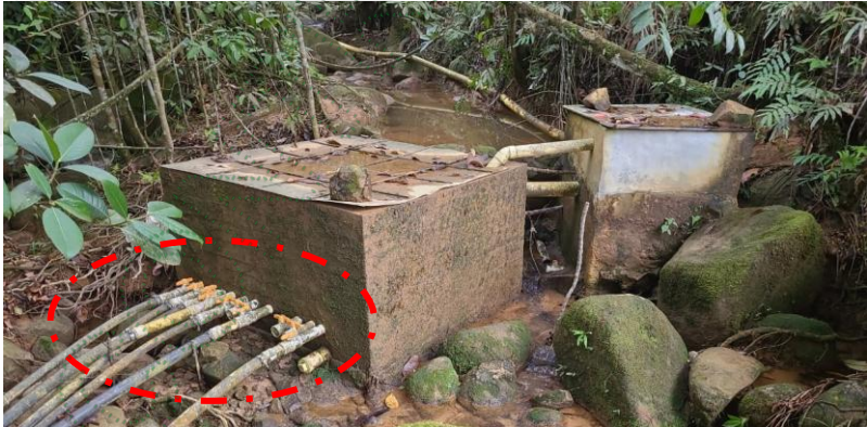
Figura 5. Desarenador y tanque de almacenamiento
