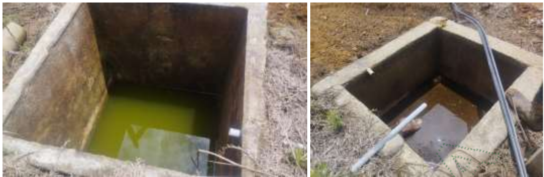
Quintero A. 2025. Obra de captación inhabilitada.
