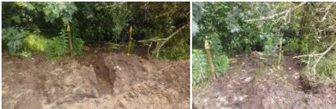
Quintero A. 2025. Afectación a la Fuente El Faro.
