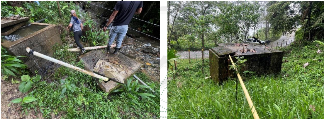
Fotos 5 y 6. Tanque desarenador y tanque de almacenamiento. Fuente: Cornare 2025
