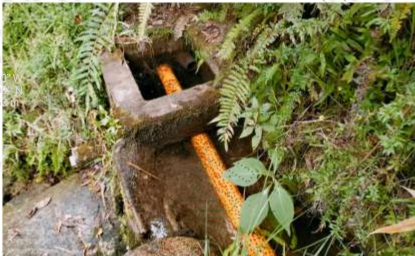
Imagen 3 y 4. Punto de captación y red de conducción en la fuente hídrica El Águila.
